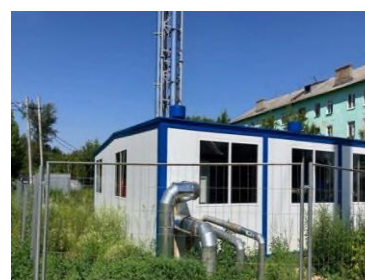
БМК № 1, г. Куровское (5,1 МВт)
