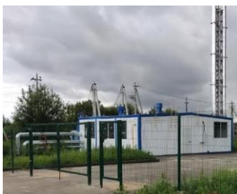
БМК д. Соболево (4,8 МВт)
