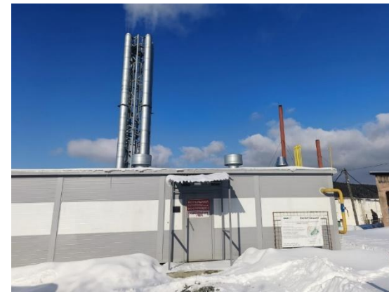
БМК №21 в г. Корсаков
