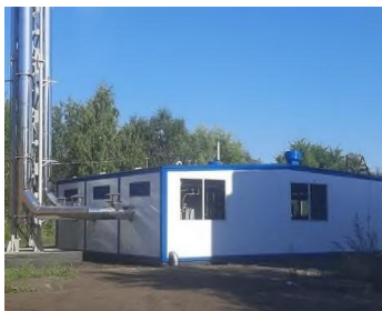
БМК № 6, д. Губино (5,1 МВт)
