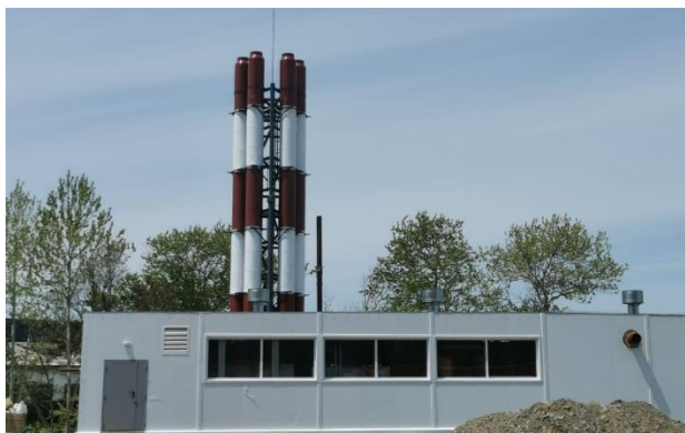
БМК №25 в г. Корсаков
