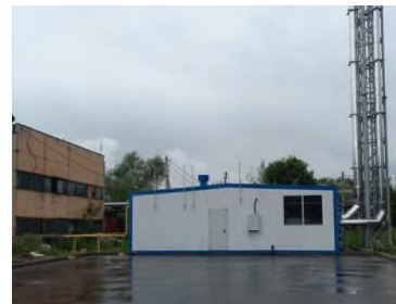
БМК № 7, д. Губино (4,5 МВт)
