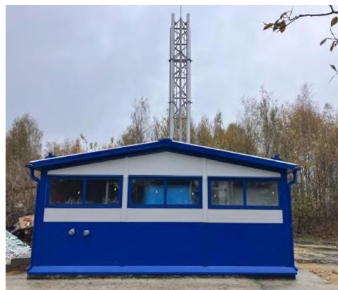
БМК п. Мисцево (2,7 МВт)
